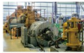
揚水発電機の温度・歪モニタ
